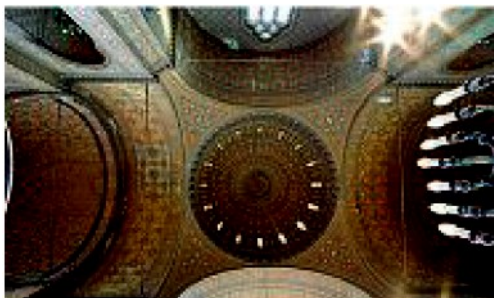
La cupola vista dal basso col rosone danneggiato
